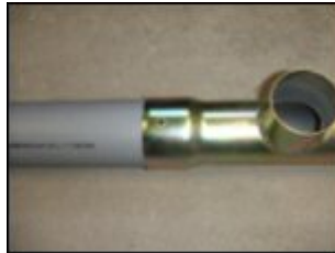
16. Выпускное отверстие пластиковой трубы должно находиться под углом 180 градусов от выпускного отверстия тройника.
